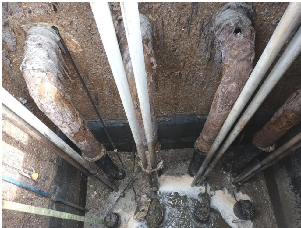
Estado impulsiones actuales EBAR Géminis
