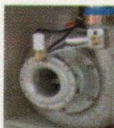
Caudalímetro en el núcleo de entrada
