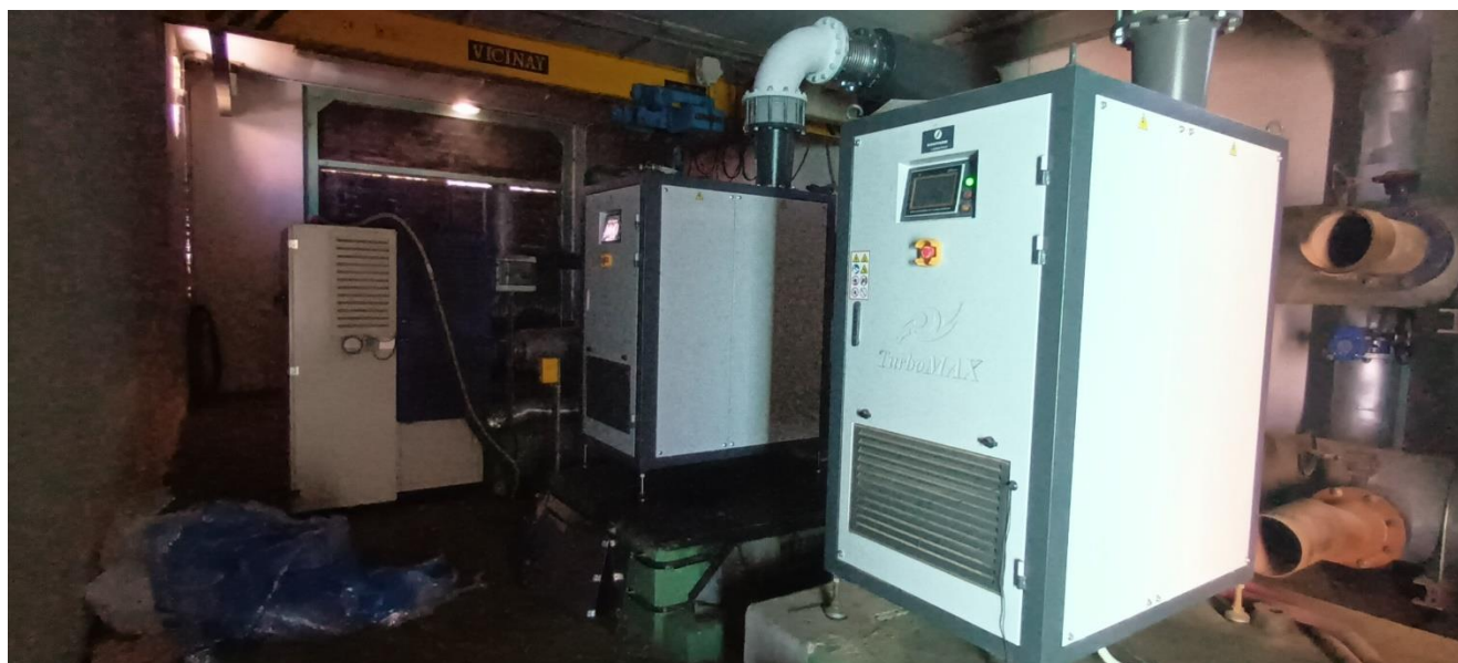
Soplante existente de levitación por aire en primer plano Xylem y de levitación magnética Sulzer en tercer plano. Soplante nueva Xylem instalada (objeto de esta inversión) en segunda posición
