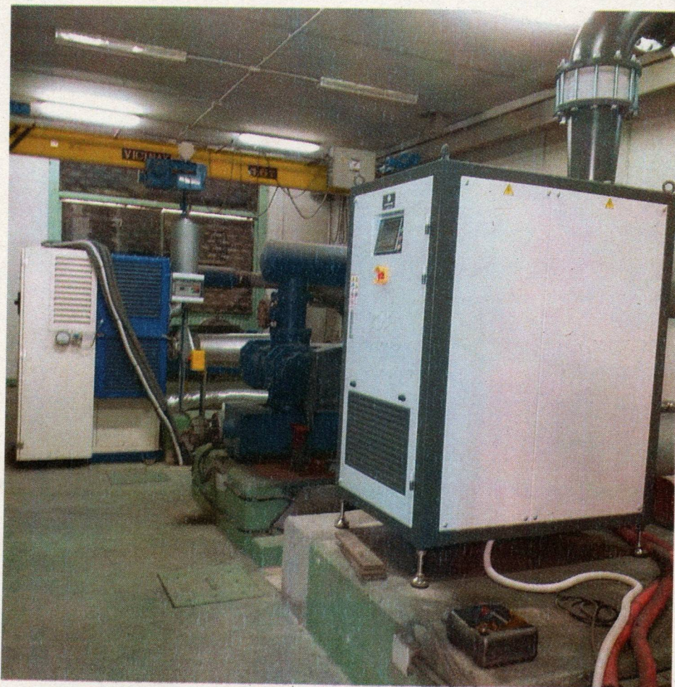
Sala de soplantes, con soplante Mapner en el centro, prevista a ser sustituida por una de levitación por aire
