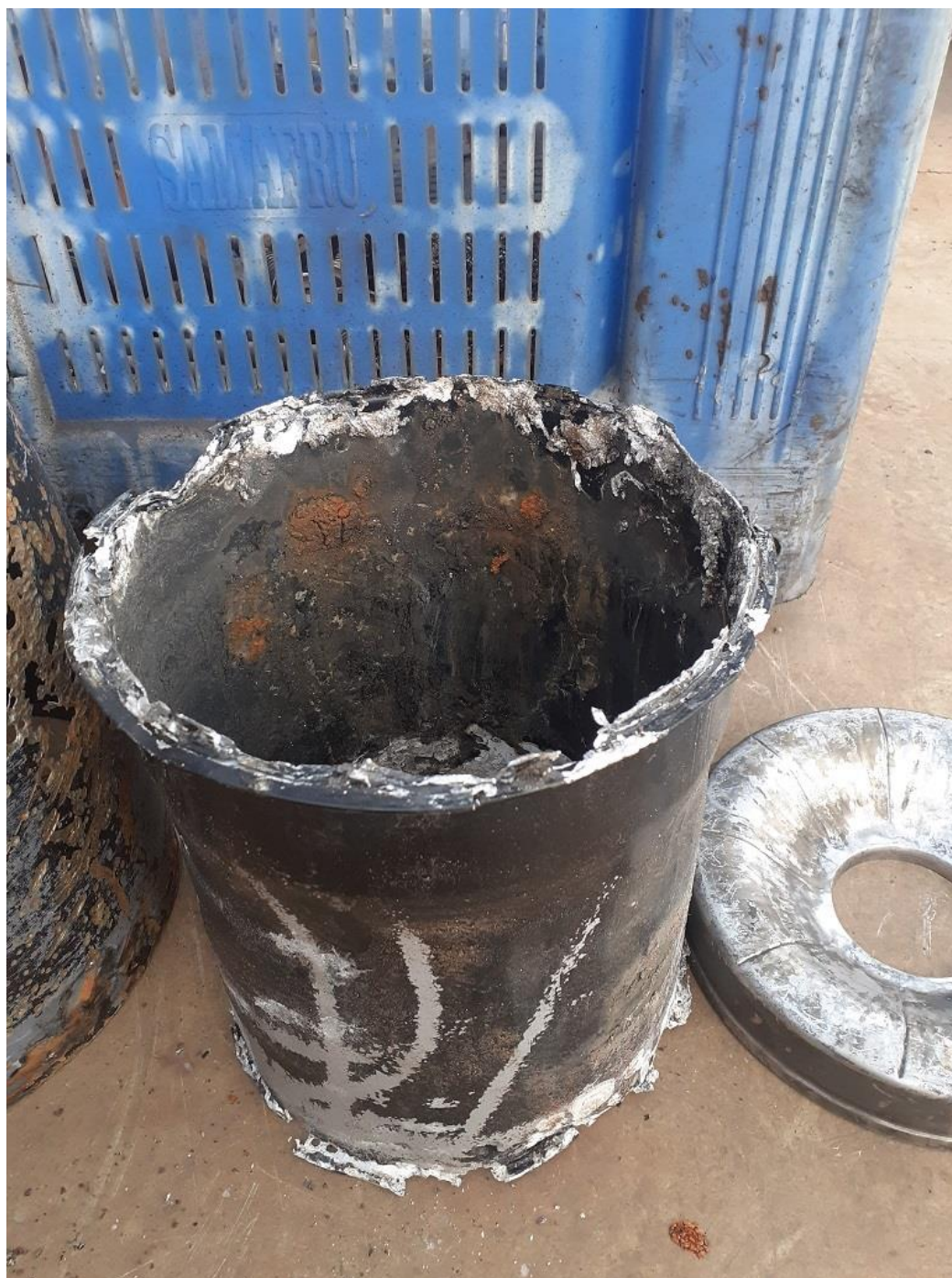
Cuerpo de la bomba, muy descompuesto
