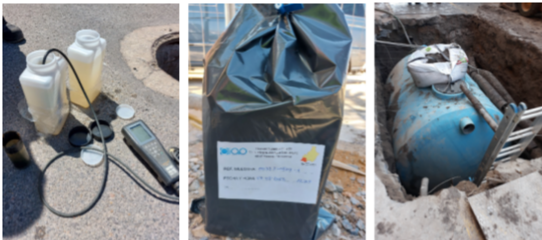
Toma de muestras tras instalación de separador de grasas
