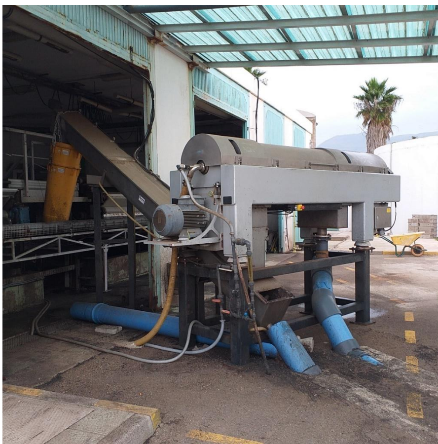
Fotografía decantador centrífugo instalado en la EDAR El Ejido, junto con tornillo elevador de fangos a la cinta transportadora
