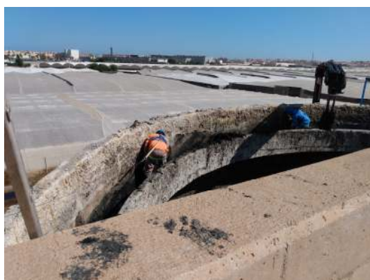
Detalle de los trabajos de acondicionamiento del tampón cuando se derrumbó la cubierta.
