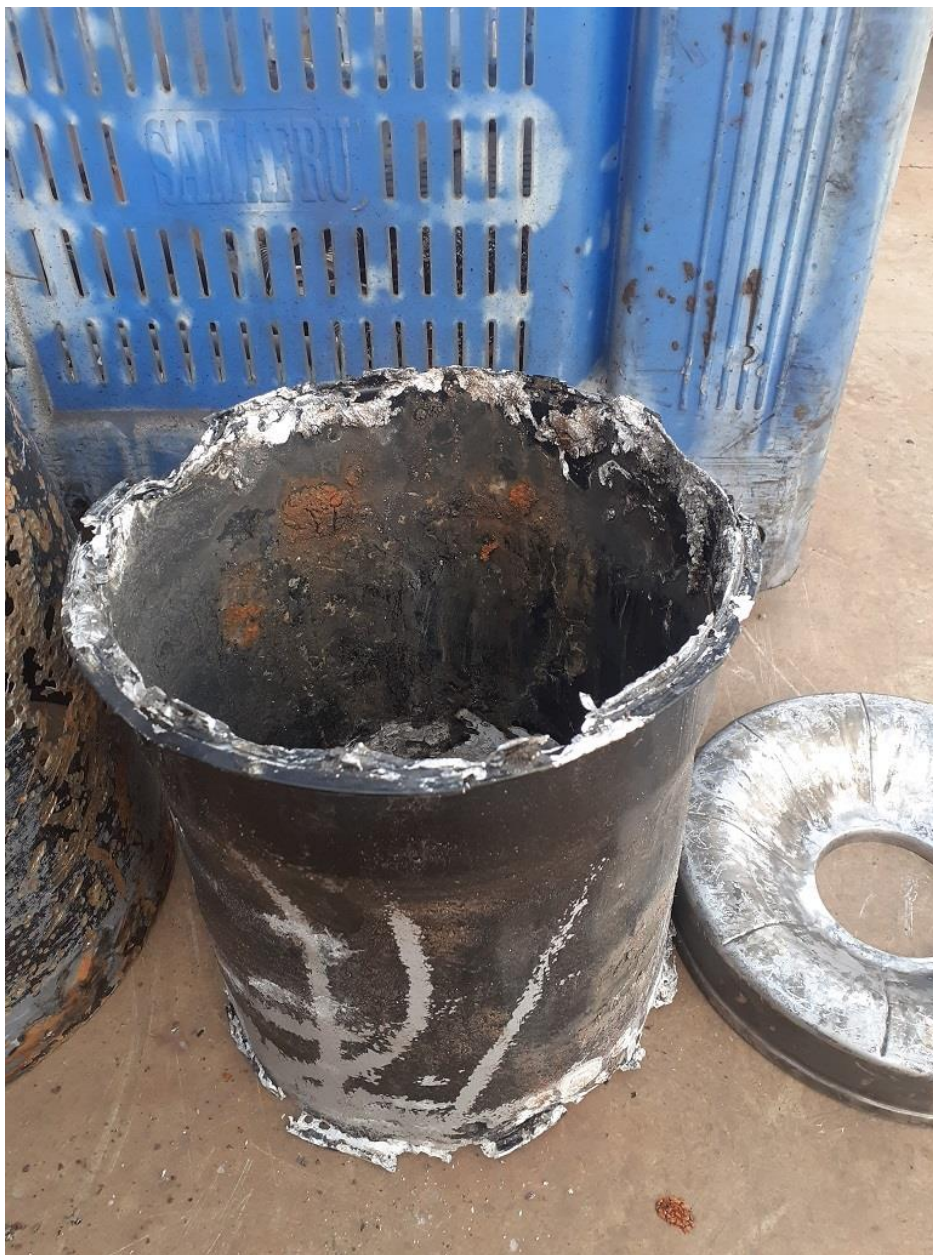
Cuerpo de la bomba, muy descompuesto
