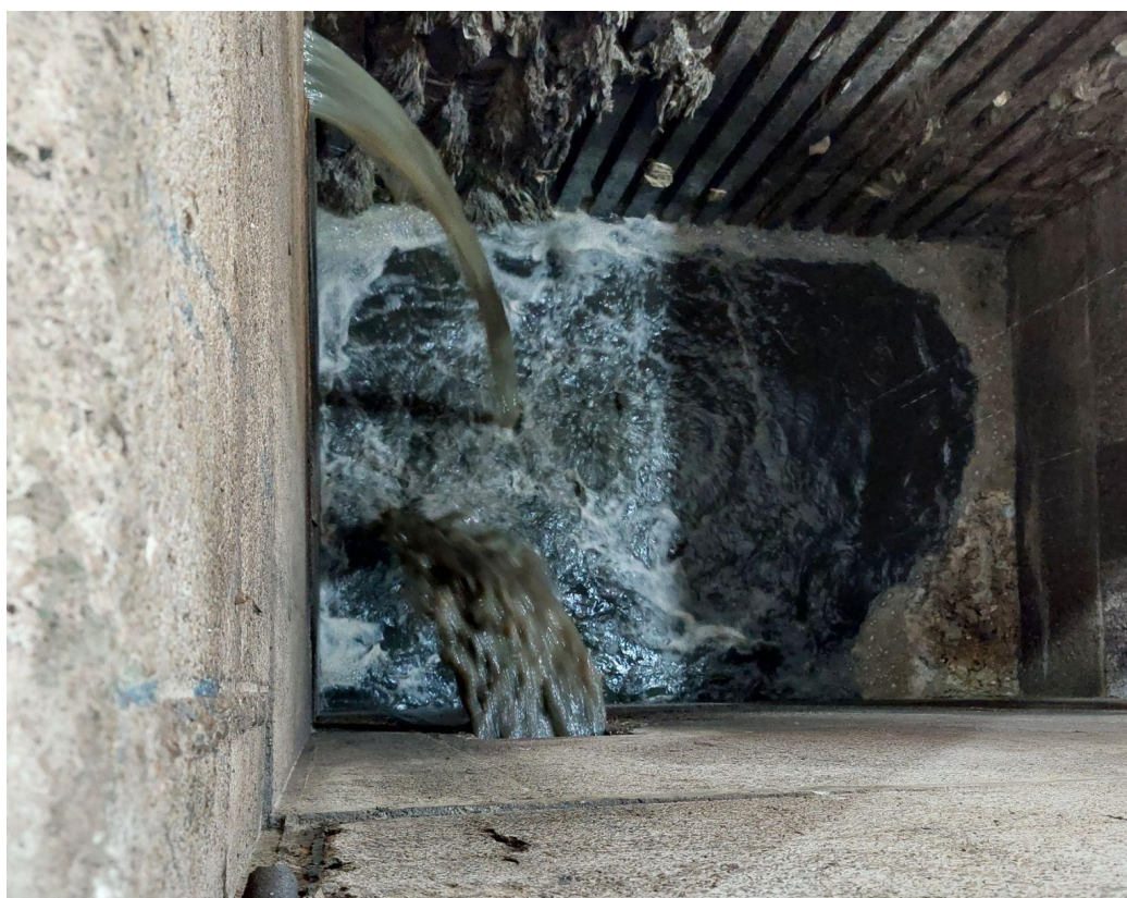
Foto entrada vertido colector de Vúcar
