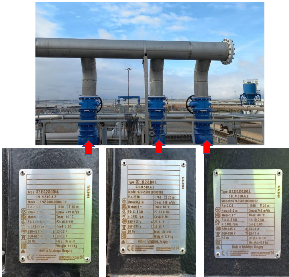
Ilustración 6: Bombeo agua clarificada a tamices rotativos. Placas de las bombas instaladas y situación.
