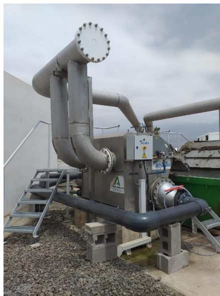
Ilustración 9: Tamiz rotativo A con nueva tubería de desagüe.
