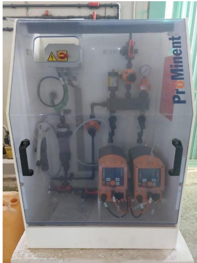
Ilustración 22: Sistema de dosificación de hipoclorito sódico.
