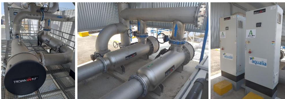
Ilustración 17: Sistema de desinfección de la línea convencional (izquierda), línea MBR (centro) y sistema de control (derecha).
