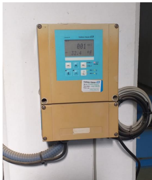
Ilustración 5: Medidor de cloro a la salida del tratamiento terciario.
