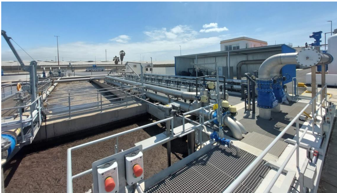
Ilustración 11: Vista de la línea MBR.
