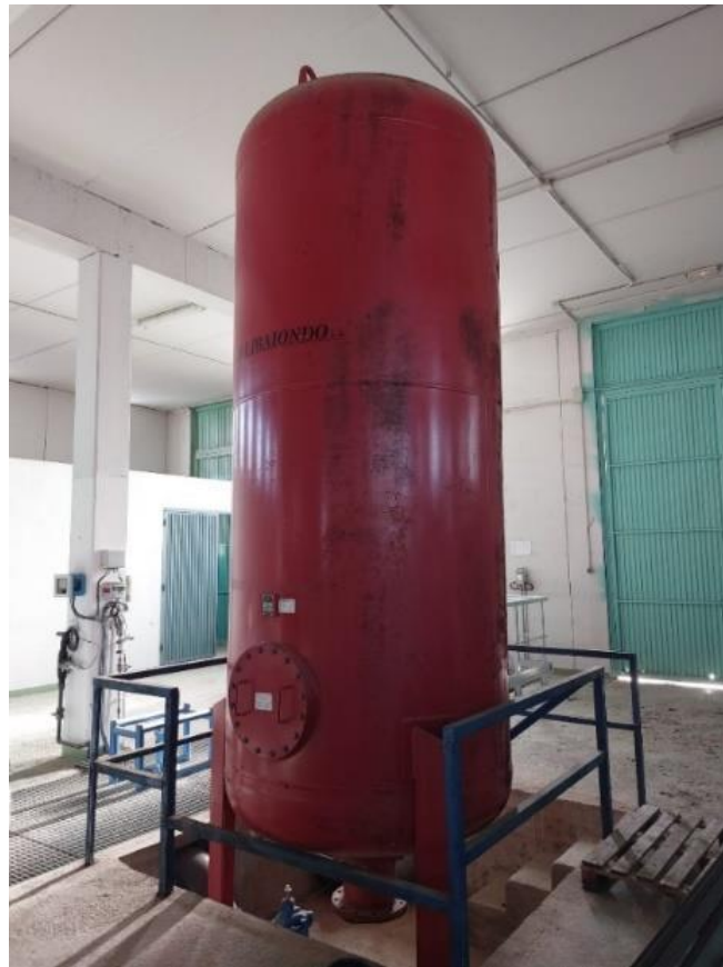
Ilustración 3: Calderín de la impulsión a los puntos de entrega.
