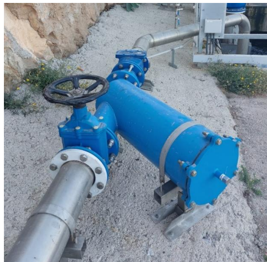
Ilustración 13: Impulsión y filtro para el agua de mezcla de la limpieza química del MBR.
