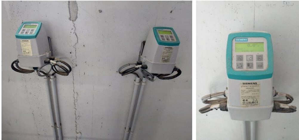
Ilustración 4: Caudalímetros salida agua regenerada.
