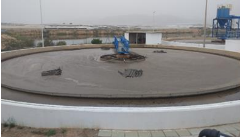
Imagen del decantador secundario tras la puesta en marcha del MBR
