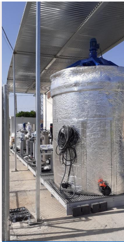
Conexión eléctrica y cableado
