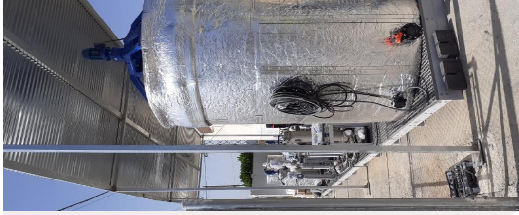
Conexión eléctrica y cableado
