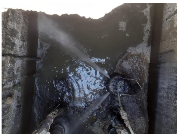
Estado actual bomba impulsión A
