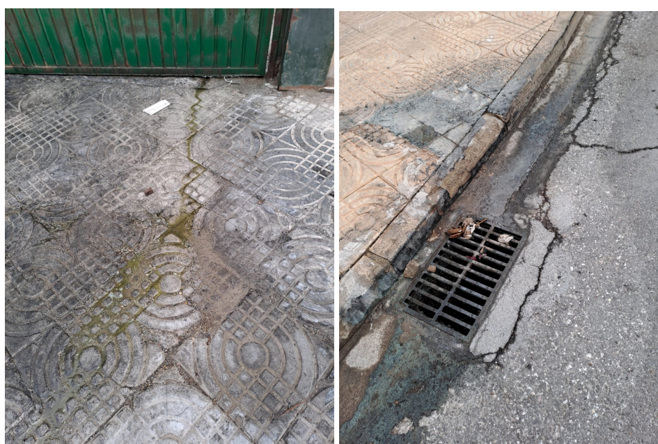
Foto izquierda: puerta de la nave de la empresa donde se ve un hilo de producto saliendo del interior. Foto derecha: alcantarilla de la red de pluviales donde llegó el agua de lavado de los bomberos con los posibles restos de producto.
