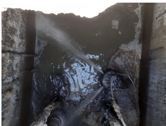
Estado actual bomba impulsión A
