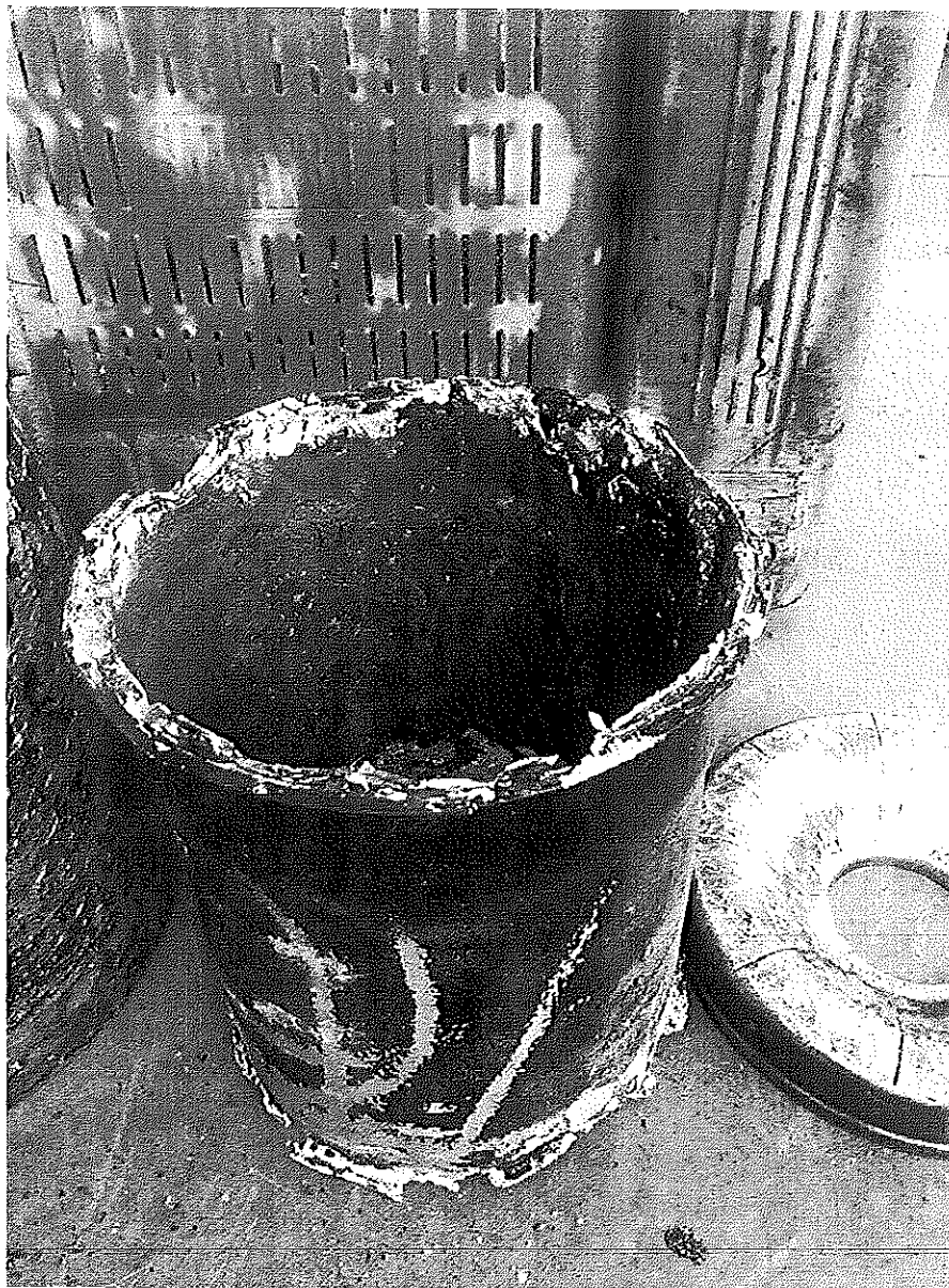
Cuerpo de la bomba, muy descompuesto
