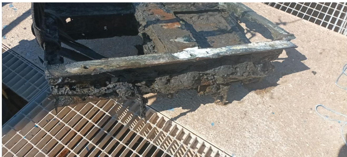
Estado de una de las compuertas sustraídas en previsión de la actuación a realizar. Se observa el tablero de taponamiento de la compuerta roto y los perfiles laterales corroídos y deteriorados
