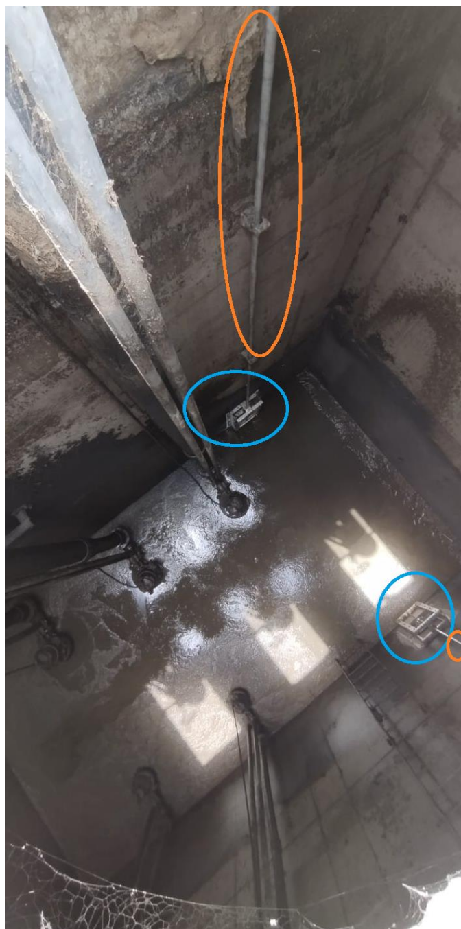
Vista de la arqueta de recirculación, con las compuertas nuevas instaladas en azul y los husillos nuevos en naranja
