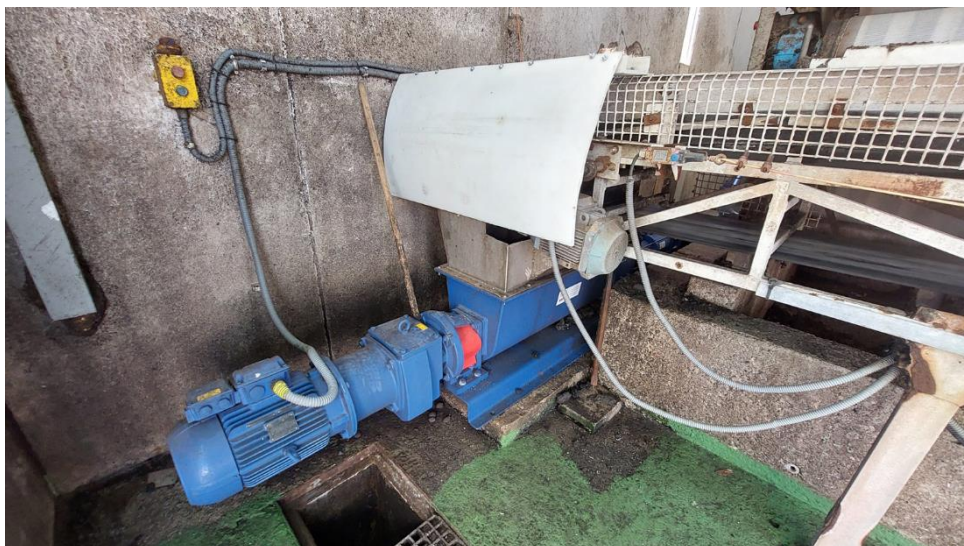
Bomba en servicio en deshidratación EDAR El Ejido
