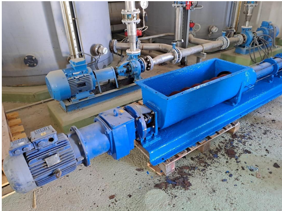
Bomba de reserva almacenada en Terciario EDAR El Ejido
