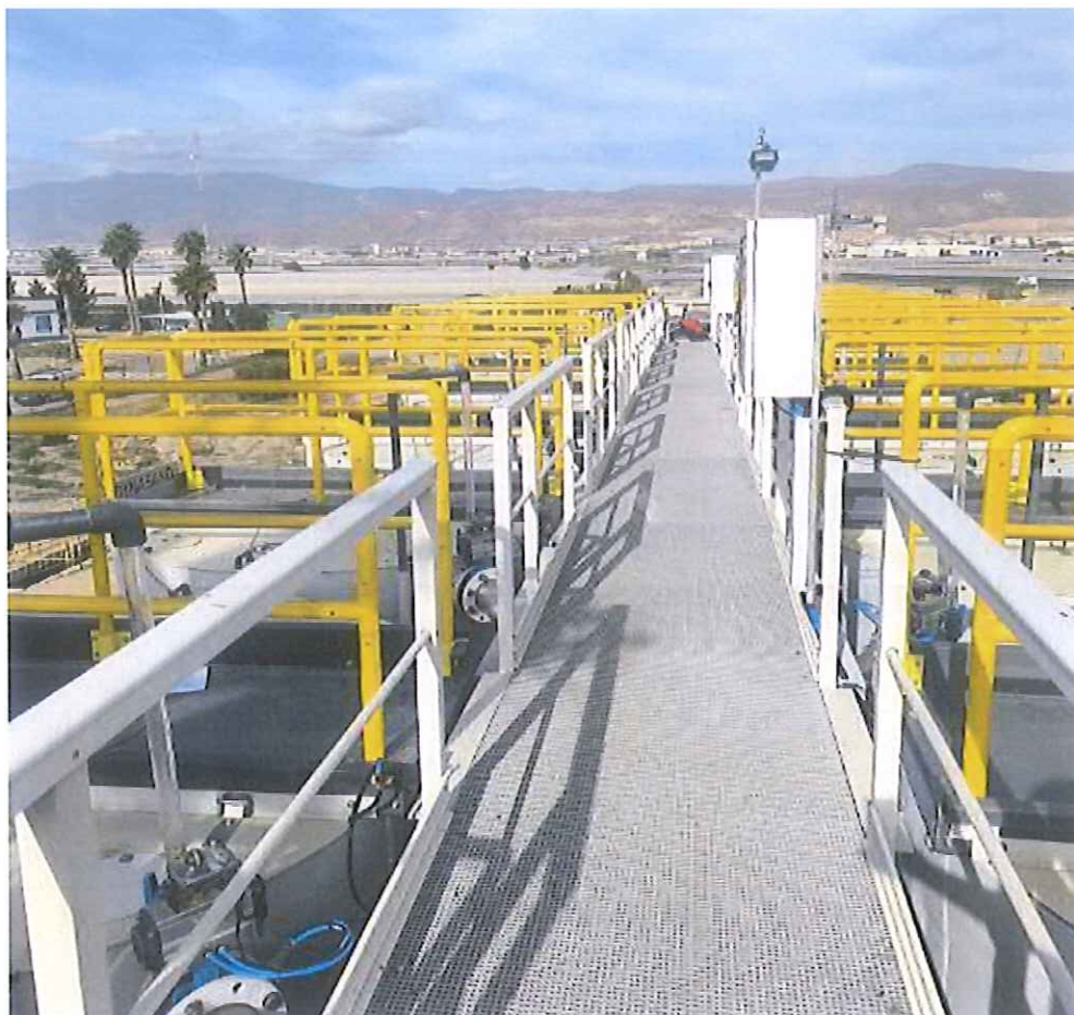
Imagen filtros de arena
