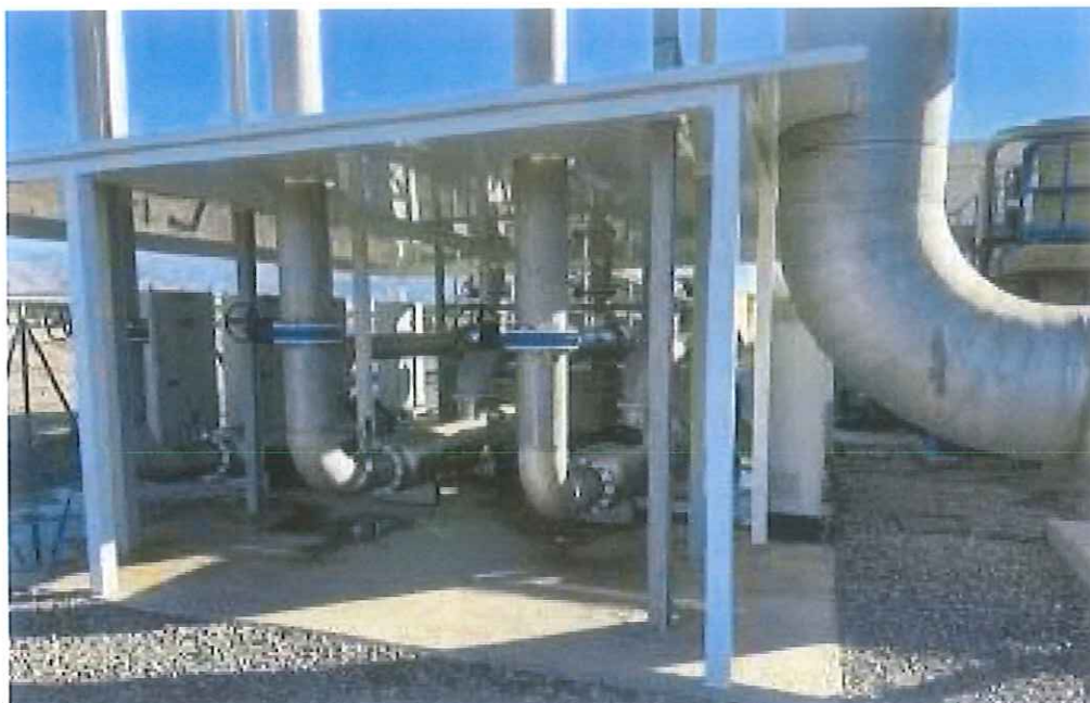
Imagen Equipos Ultravioleta
