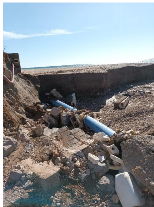
Estado tramo impulsión EBAR Balanegra tras la avenida de la rambla
