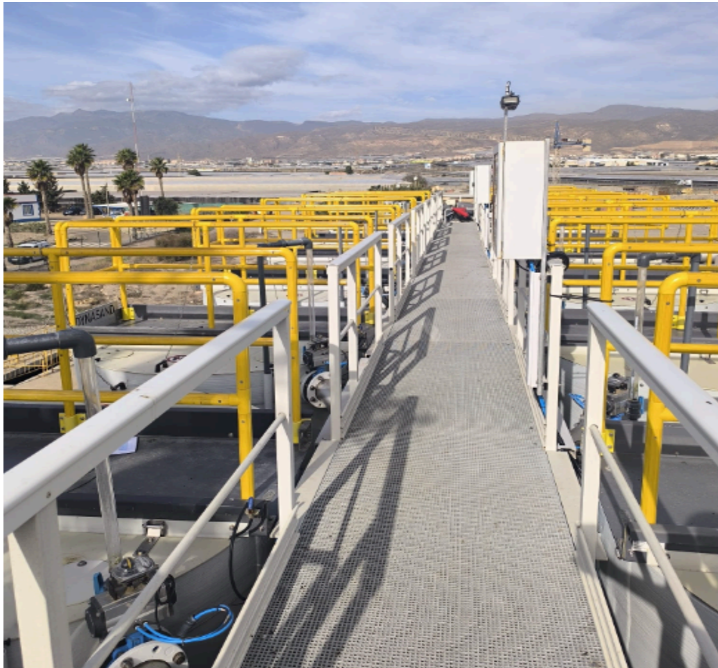
Imagen filtros de arena
