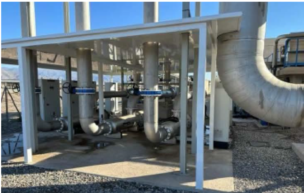
Imagen Equipos Ultravioleta
