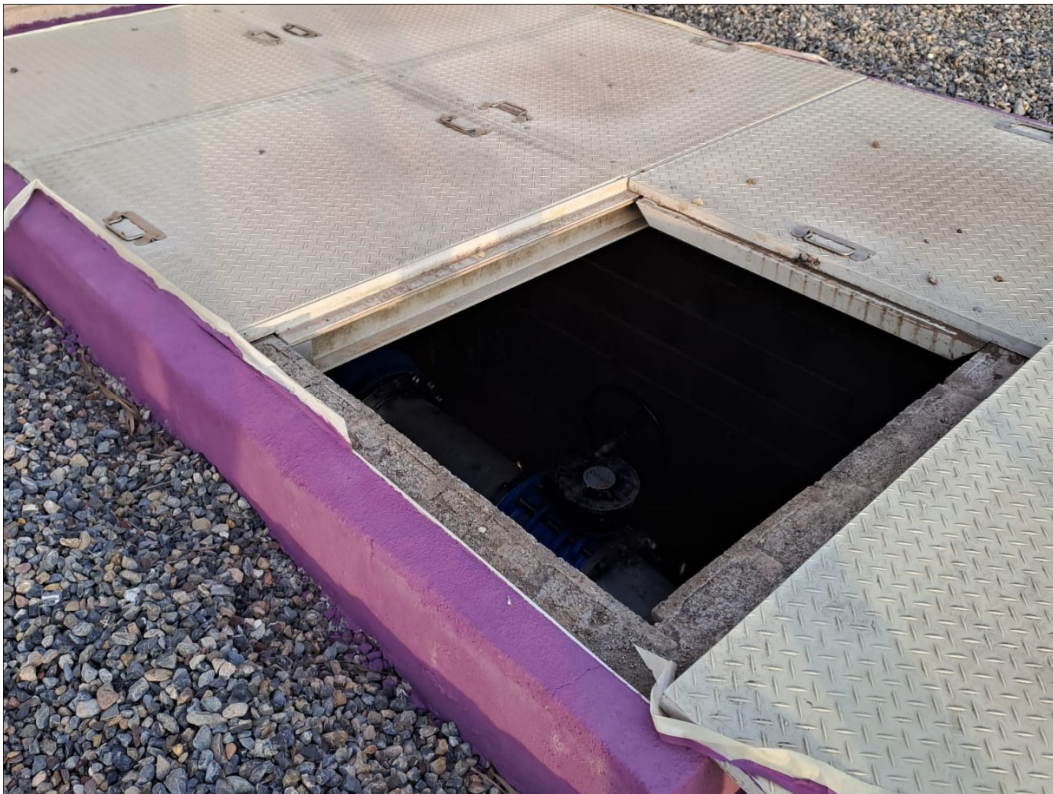
Arqueta de ubicación del Contador 1 (Q1): CCRR Sol y Arena
