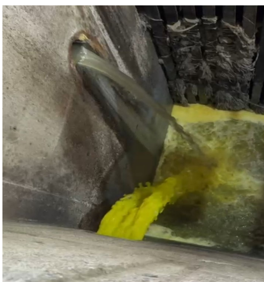
Foto: Pozo de VÍcar en entrada a EDAR de Roquetas que muestra el vertido de color amarillo
