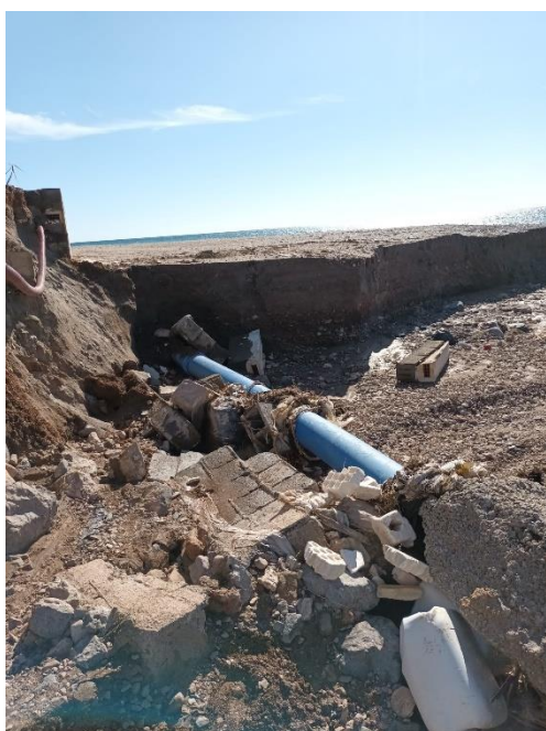
Estado del tramo de impulsión tras la riada
