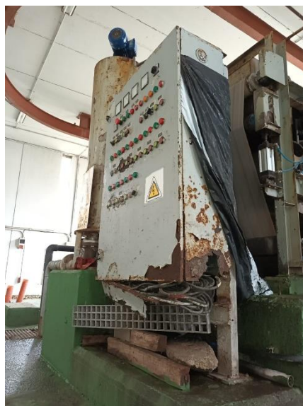
Vista lateral armario eléctrico
