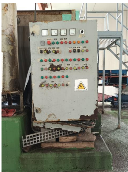
Vista frontal armario eléctrico
