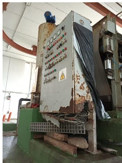
Vista lateral armario eléctrico
