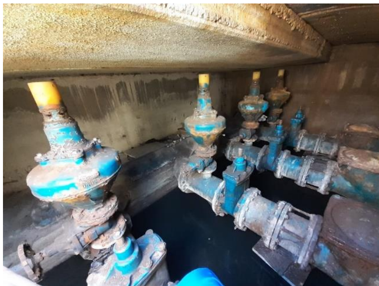
Ilustración 1: Estado de las ventosas de EBAR Géminis
