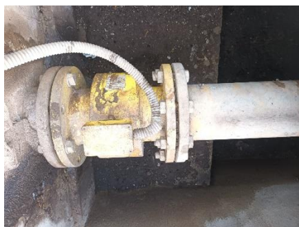
Ilustración 1: Caudalímetro de agua residual bruta de la EDAR de Dalías.
