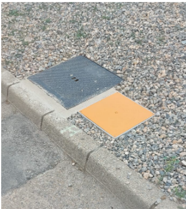
Arquetas estancas en material plástico impermeables al ClFe3
